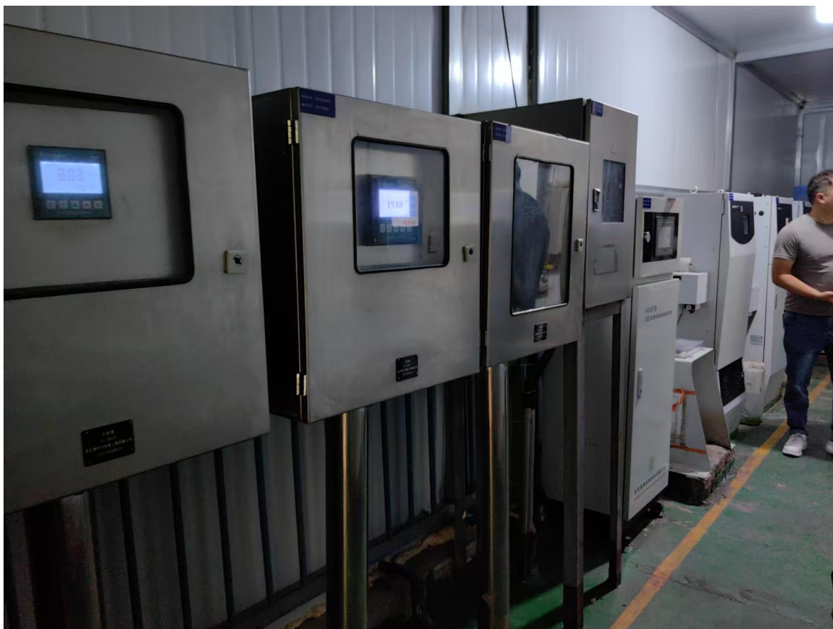
昌都市生态环境局执法支队检查污水处理厂在线监测系统
